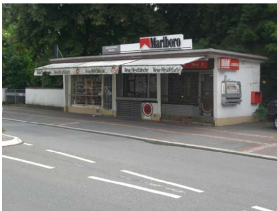
Abbildung 6: abgängige Bausubstanz mit Mindernutzung
